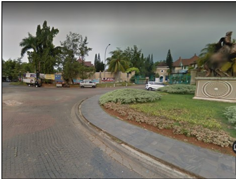
Gambar 2.1. Celah / Joint yang terisi pasir tidak sempurna, karena kegagalan pelaksanaan dan pemeliharaan kedap air yang tidak maksimal.
