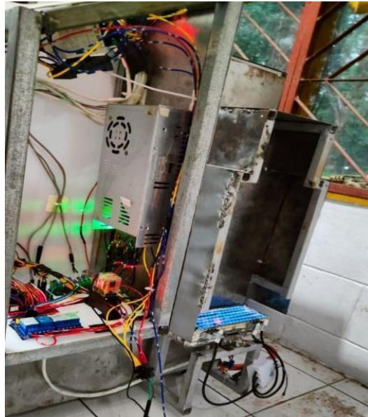
Gambar 4. 45 Kondisi burner aktif pada suhu <60^{\circ}\text{C} .
