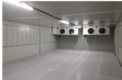
Gambar 2.2 Bagian dalam ruangan cold storage
