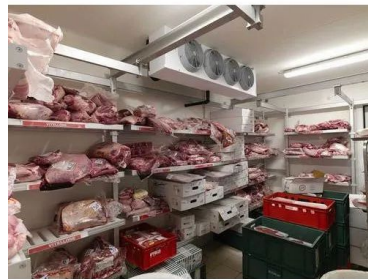
Gambar 2.4 Ruangan dalam freezer room
