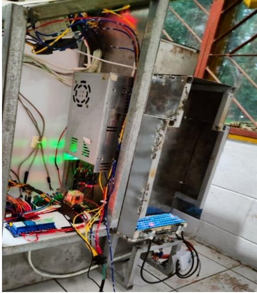
Gambar 4. 45 Kondisi burner aktif pada suhu <60^{\circ}\text{C} .
