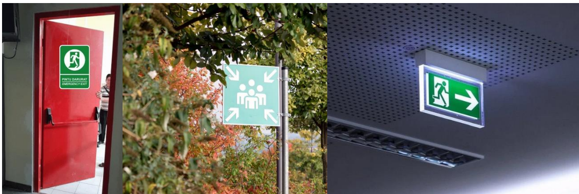
Gambar 5.20 Pintu Darurat (1) Logo Titik Kumpul (2) Exit (3) (sumber: https://www.pengadaan.web.id/2020/11/jalur-evakuasi-gedung.html , di akses 22/5/2022 pukul 18:10 WIB)
