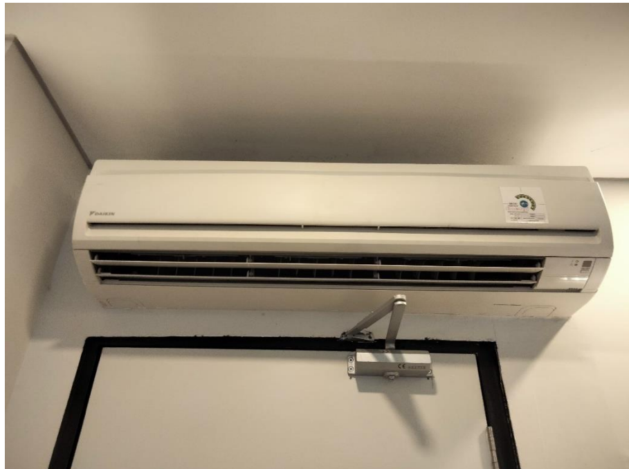
Gambar 5. 14 Contoh Penghawaan Buatan Berupa Air Conditioner (AC) pada Unit Kamar Qubika Hotel
