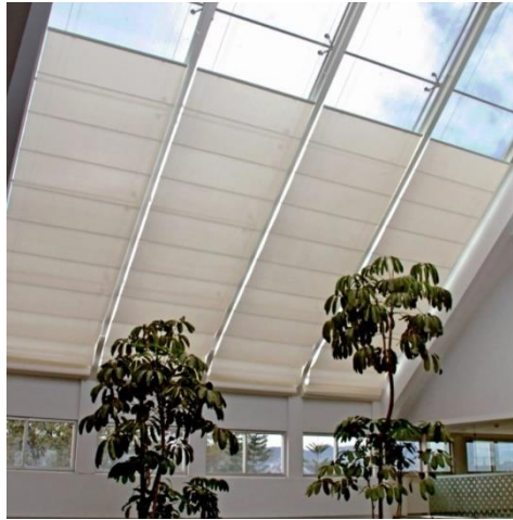
Gambar 5. 2 Skylight yang dapat di buka tutup
