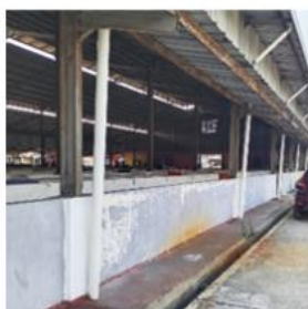
Tinggi dinding kurang dari 3 meter
